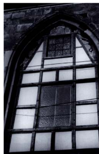
Notdürftig mit Pappe repariertes Fenster
