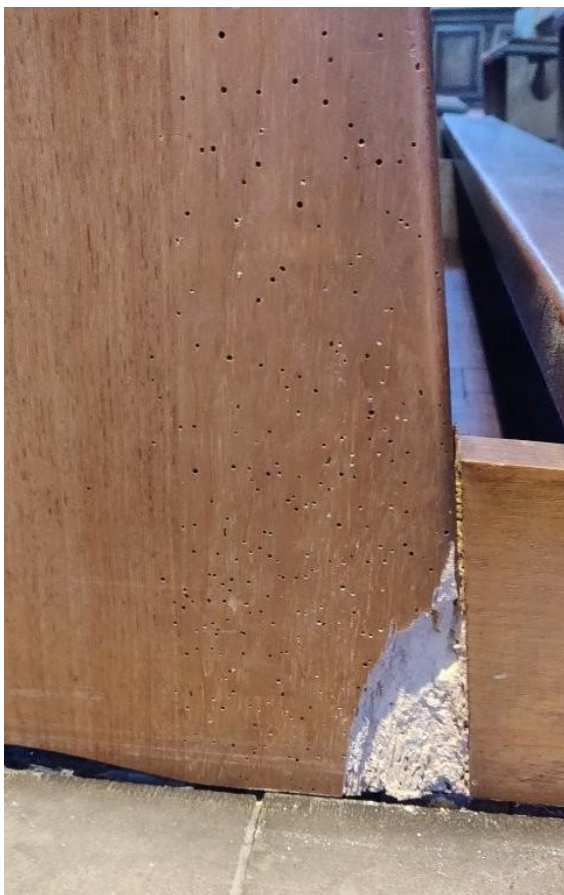
Holzwurmschaden in der Liebfrauenkirche Foto: Edgar Martin
